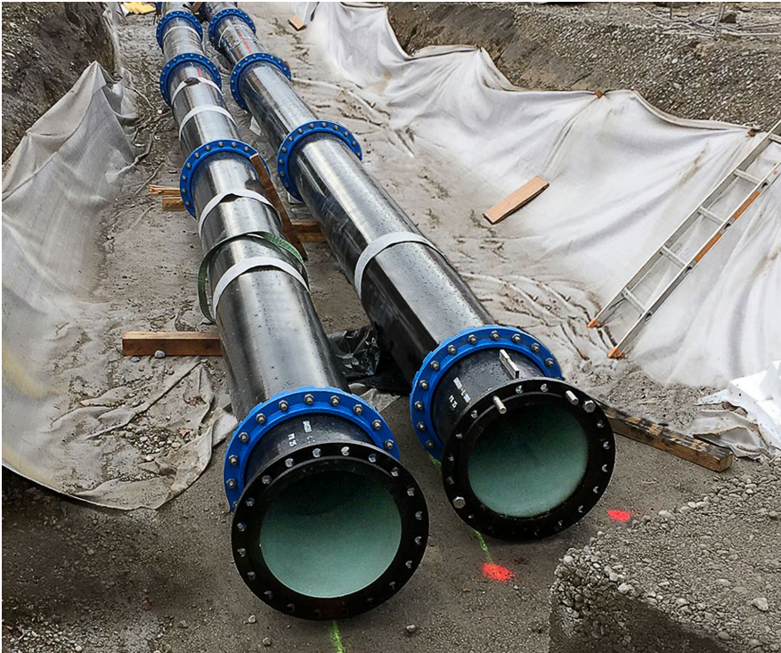
Conduite double ARA Werdhölzli DN 600, PFA 25 bar
