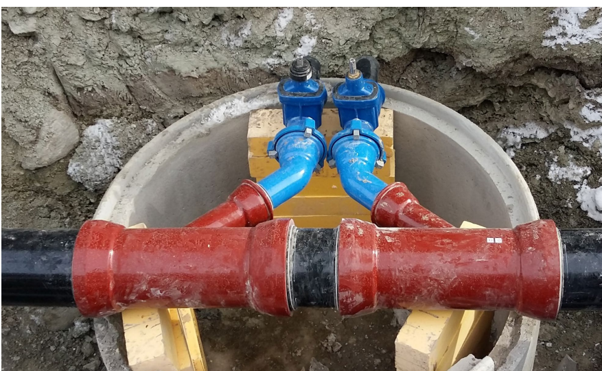
ECOPUR DN 250 avec raccordement pour maison DN 100 vers l'échangeur de chaleur
