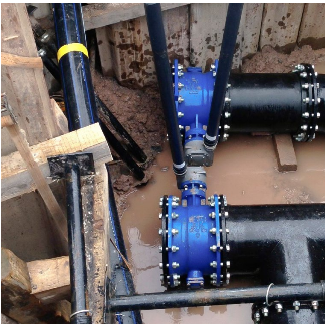
Seitenabgänge mit Absperrklappen DN 400
