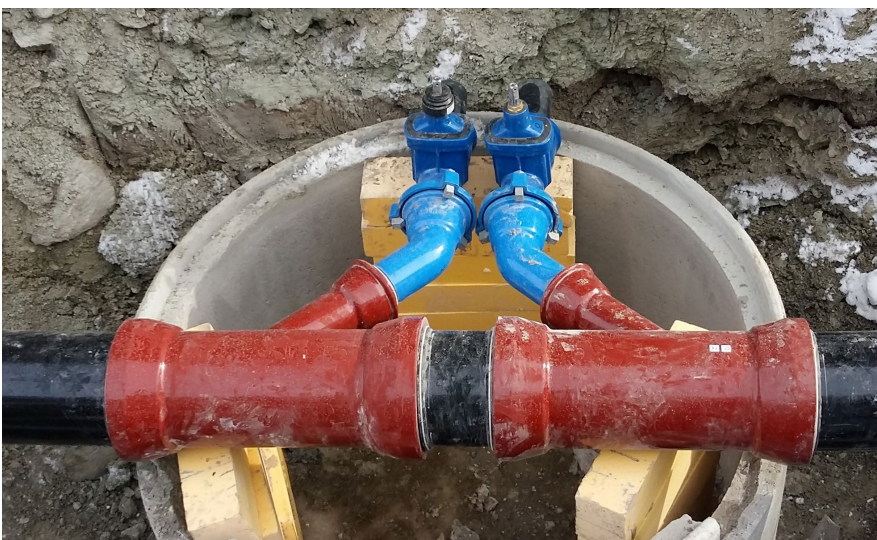
ECOPUR DN 250 con acometida DN 100 al intercambiador de calor
