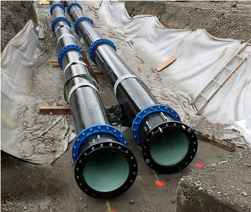
Conducto doble ARA Werdhölzli DN 600, PFA 25 bar
